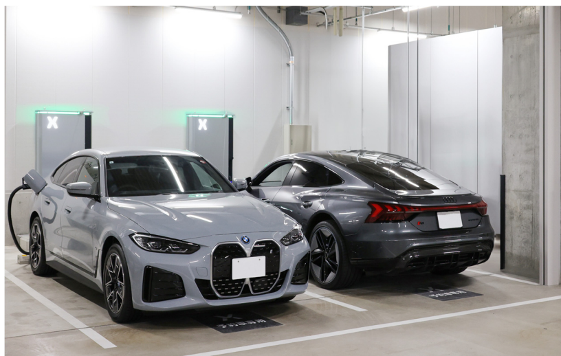
< パワーエックスの EV チャージステーション >
