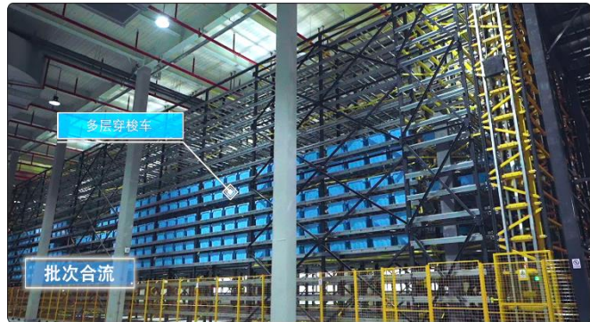
図 2： レール上を走行する四方向シャトル。 「パレット・トゥ・パーソン」のピッキング方式に対応
