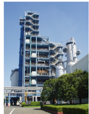
川崎プラスチックリサイクル (KPR) プラント
