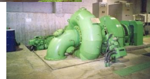
那須野ヶ原発電所
